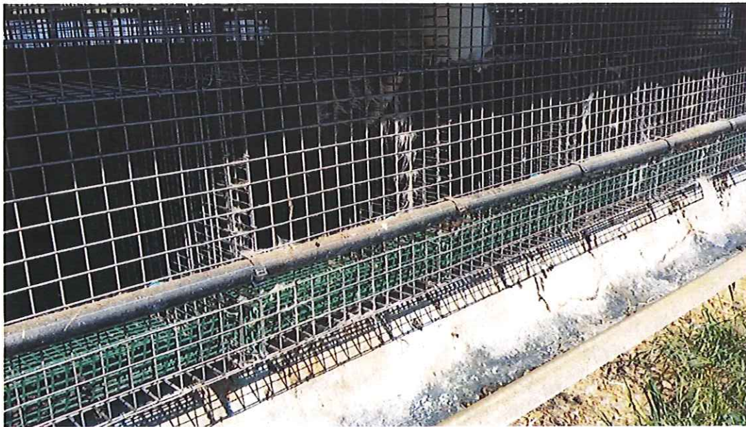
Gouttière de réception des excréments
